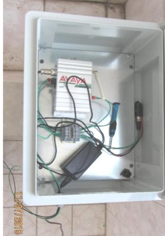
شکل ۱. تصویر دیتا لاگر نصب شده
