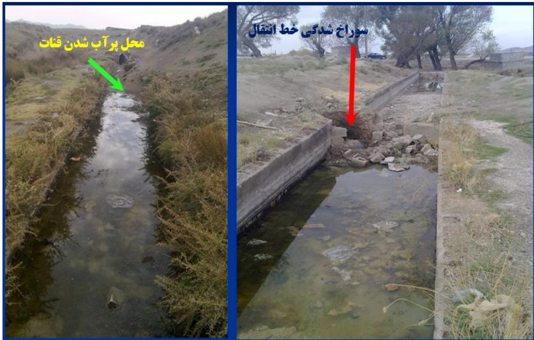
شکل ۲: سوراخ شدن خط انتقال آب قروه و هدر رفت آب
