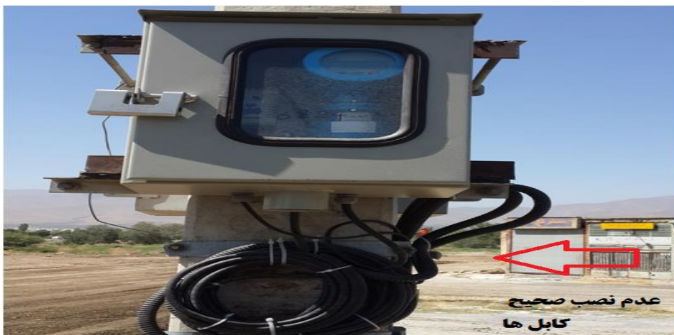
شکل ۱: عدم نصب صحیح کابل نمایشگر دستگاه فلومتر الکترومغناطیسی (فلومتر DMA ورودی شهرک فرهنگیان شهر همدان)
